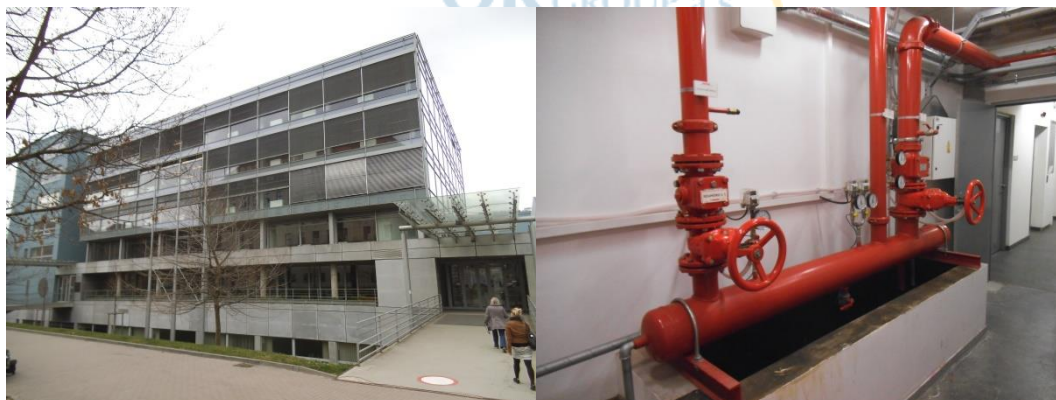
foto č. 3 a 4 – budova Q se svojí strojovnou SHZ v 1.PP
