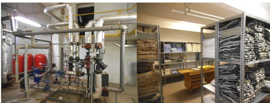
foto č. 11 a 12 – vlevo výměníková stanice tepla (1.PP); vpravo typickým prostor skladu prádla (1.PP)
