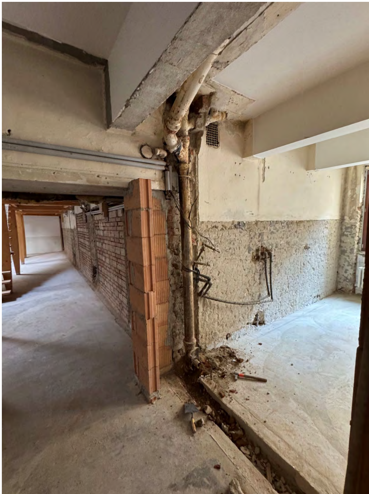
FOTO Č. 1 – POŠKOZENÝ LITINOVÝ SVOD (HAVARIJNÍ STAV)
