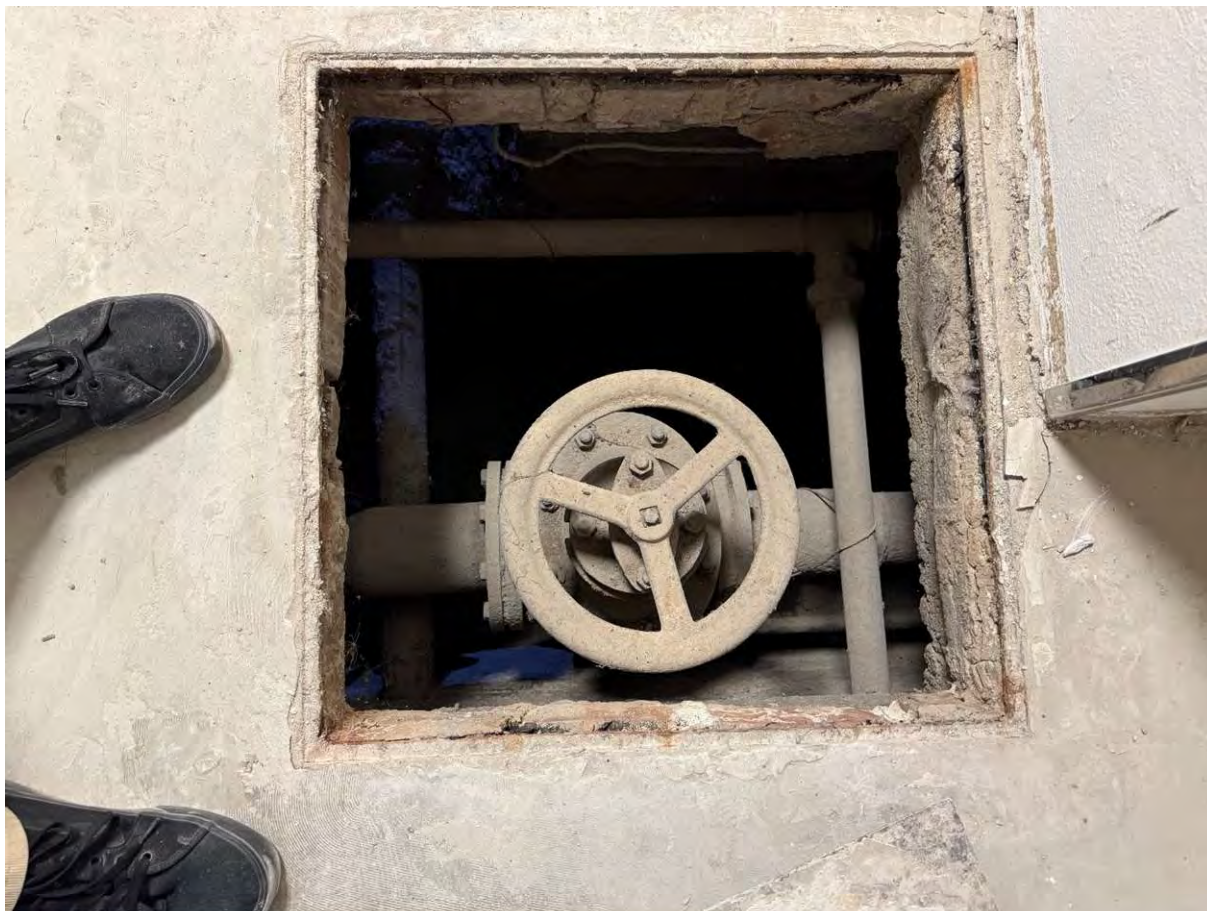
FOTO Č. 14 – NEZNÁMÝ ROZVOD S UZÁVĚREM V TECHNOLOGICKÉM KANÁLU
