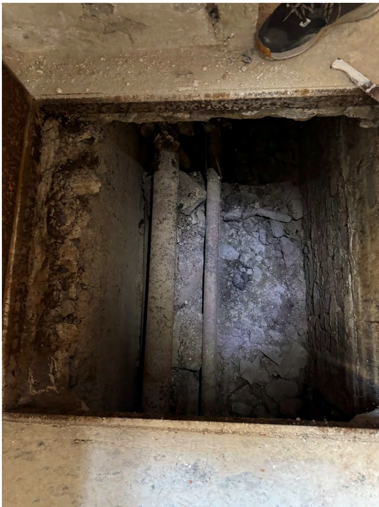
FOTO Č. 17 – NEZNÁMÉ ROZVODY V TECHNOLOGICKÉM KANÁLU
