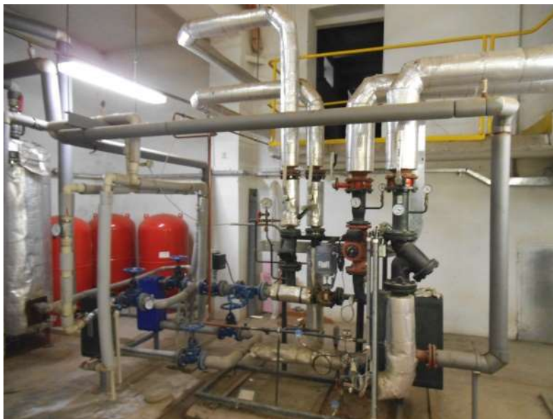
Fotografie 22: Výměníková stanice v 1.PP
