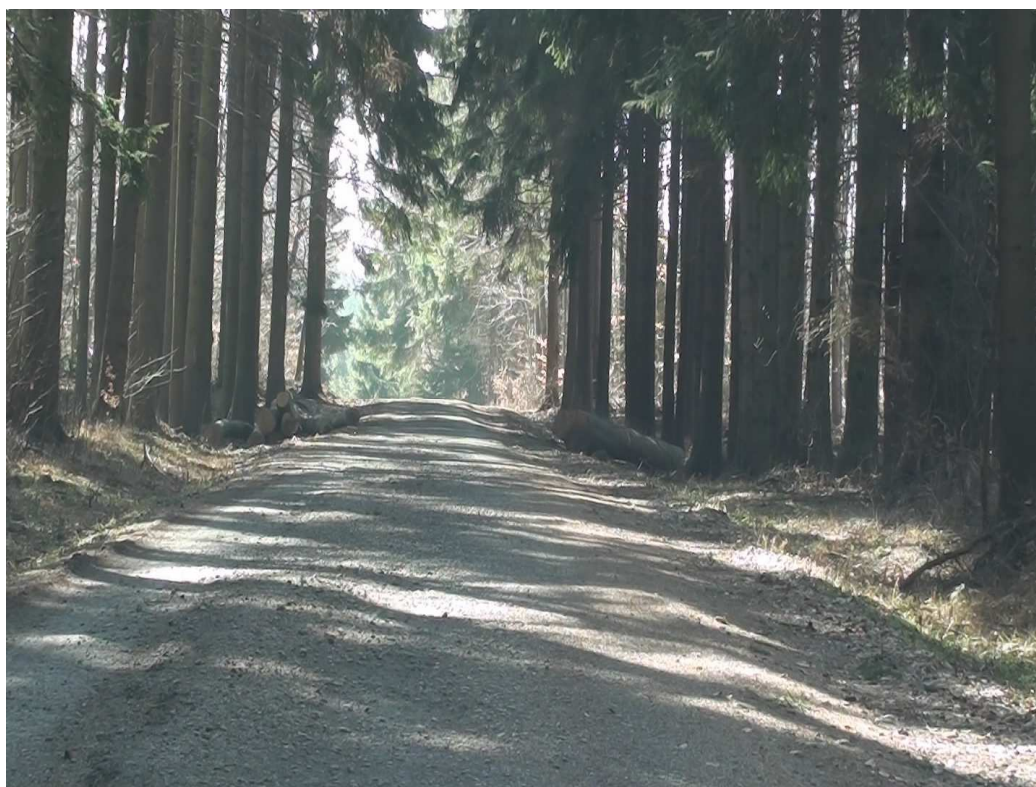
Vyjetá kolej vlevo v km 0,960 – pohled ve směru jízdy
